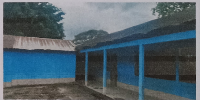
Foto 4: Laminas completamente dañadas del modulo #2
